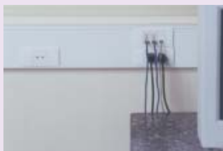
Estação de trabalho pronta para funcionar
